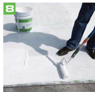
8 Al siguiente día colocar otra capa de Elastik en sentido opuesto [ \frac{1}{2} L. x m 2 ] y dejar secar
